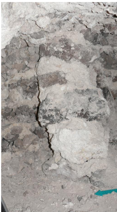
Figura V-12: Muro de contención 6 (lote 19) el cual divide el encajonamiento 4 (lotes 16, 17 y 18) en dos partes, UAX 11C Unidad 5 (Foto por M. Kováč)
