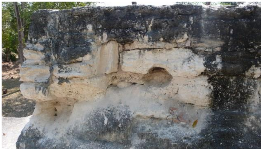
Figura XIII-9. Detalle de la disgregación debida a la presencia de insectos en el paramento de la fachada Norte (Foto por Alice Desprat).
