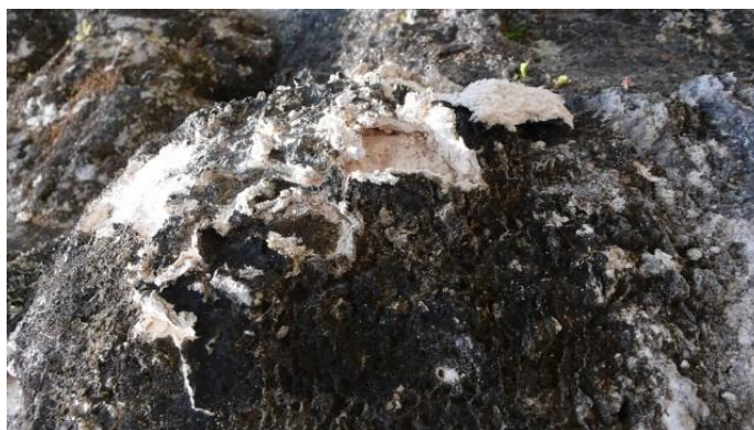
Figura XIII-5. Detalle de la costra negra con una posible reacción de sales solubles creando sub-eflorescencias (Foto por Alice Desprat).
