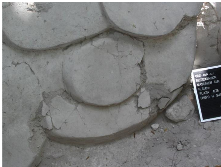
Figura XII-15: Detalle de la zona inferior del mascarón donde se observan desplazamientos y fragmentos a punto de desprenderse (Foto por Miguel Medina).
