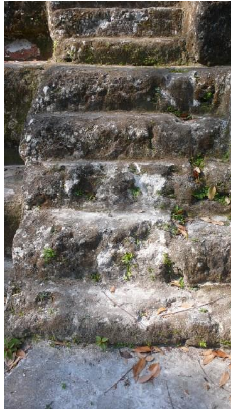
Figura XIII-4. Detalle del deterioro de las piedras que constituyen la escalinata auxiliar del lado Este de la fachada Norte (Foto por Alice Desprat).
